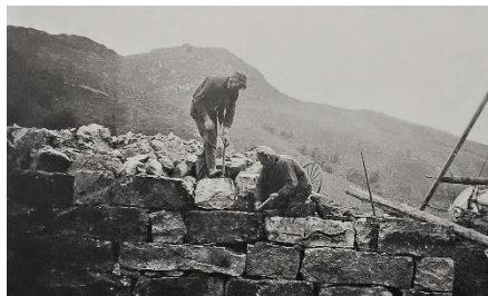
Sverre Svella t.v. og faren Elling i arbeid med låvebrua til den nye Løa bygd i 1946
