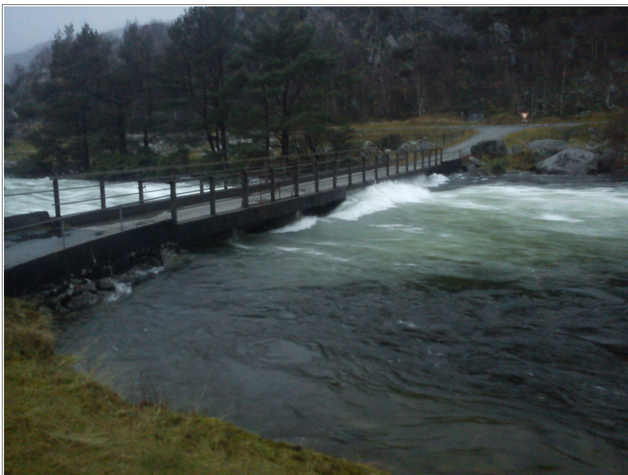
Storflaumen 6. desember 2015. Vatnet gjekk då heilt opp til brubanen, og gjorde stor skade på brukara. Brua vart stengt i mange veker, til brukara vart vølt.
